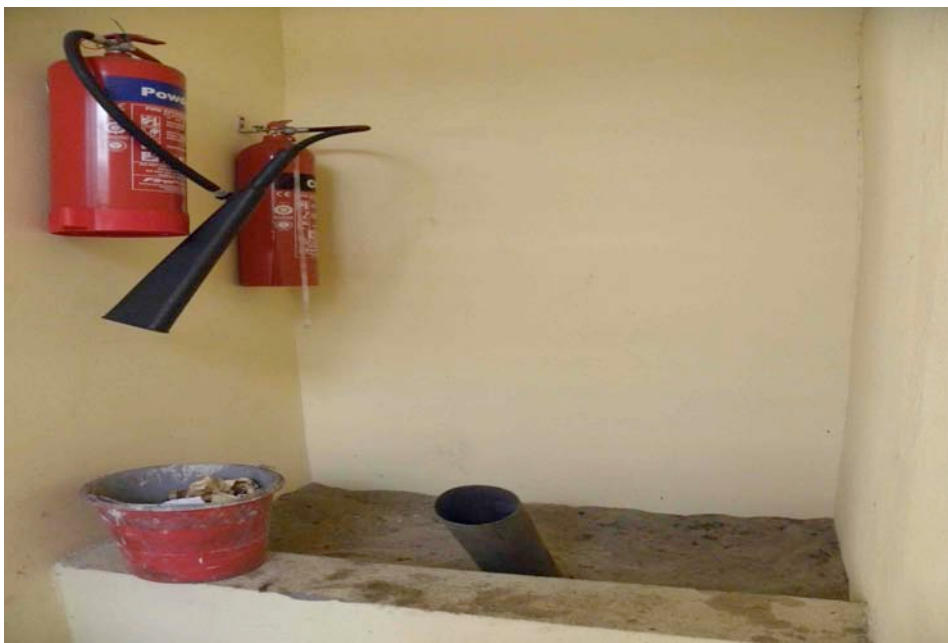
Photo 9 : Tube de décharge et extincteurs à l'entrée de l'armurerie de la Direction générale de la Police nationale
